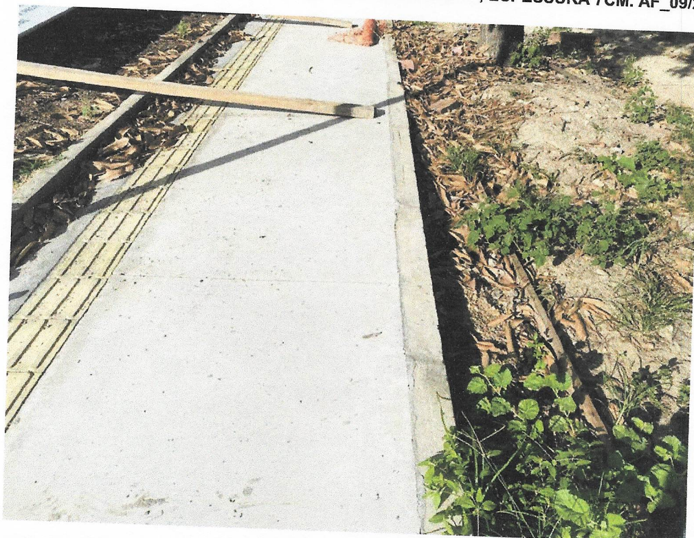
Foto 16 – ACABAMENTO POLIDO PARA PISO DE CONCRETO ARMADO OU LAJE SOBRE SOLO DE ALTA RESISTÊNCIA. AF_09/2021
